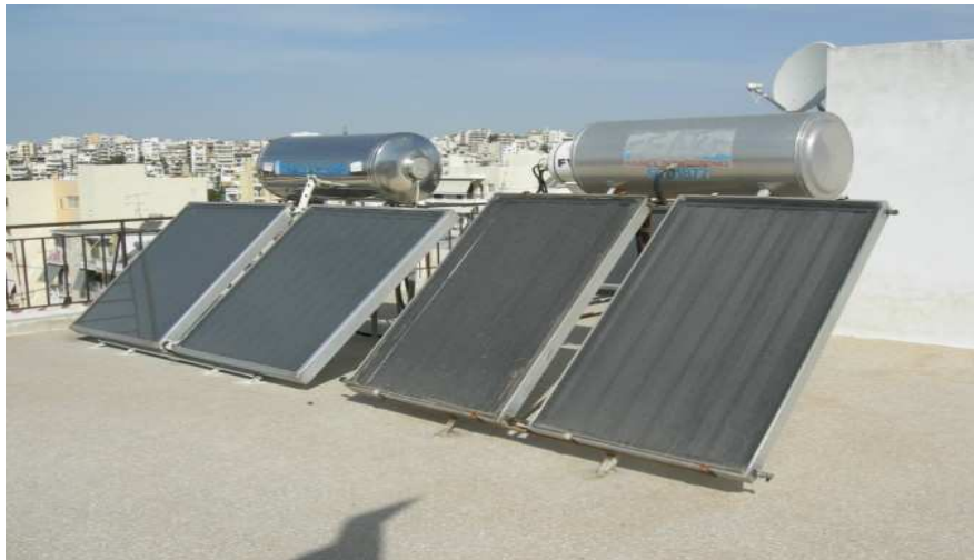
Ηλιακοί θερμοσίφωνες (φωτ. Α. Μανδρίκας)
