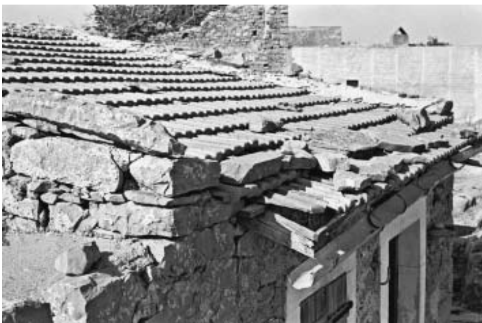
Πιν. 21β. Νοφαλιές: τσίγκινη υδρορροή στο γείσο της στέγης στον οντά του Δεσποτογιώργη, για την τροφοδοσία της δολωτής στέρνας μπροστά στον οντά (βλ. πιν. 26α).
